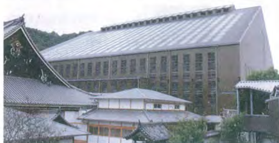
●奥：解体修理のため大殿を覆う素屋根 手前：修理の終わった集会堂と仮設建物
