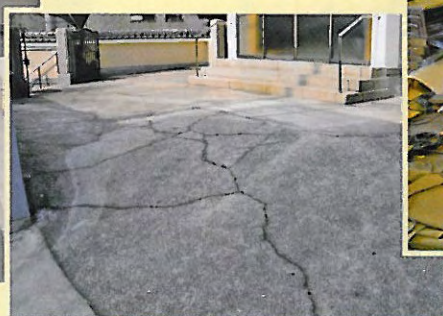
▲傷んでいた本堂前アプローチ (写真7)
