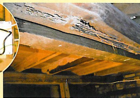
▲本堂のシロアリ被害 (写真4)
