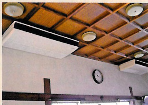
▲本堂に設置されたエアコン（写真12）
